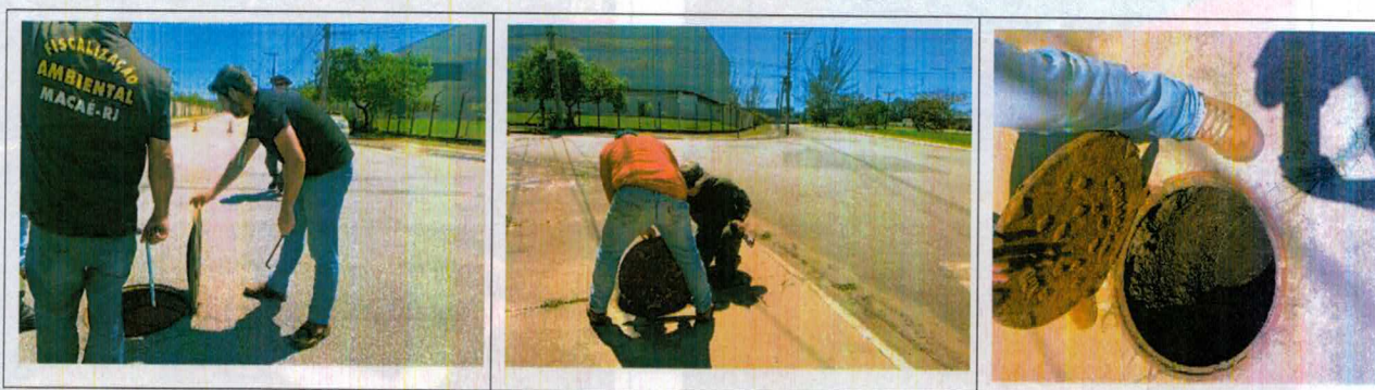
Figura 04. Caixas de inspeção da drenagem pluvial do Polo Industrial Cabiúnas.
